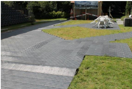
Bild 3: Falsch! Verlegung ohne Dehnungsfugen, Boden wellt sich bei Sonneneinstrahlung
